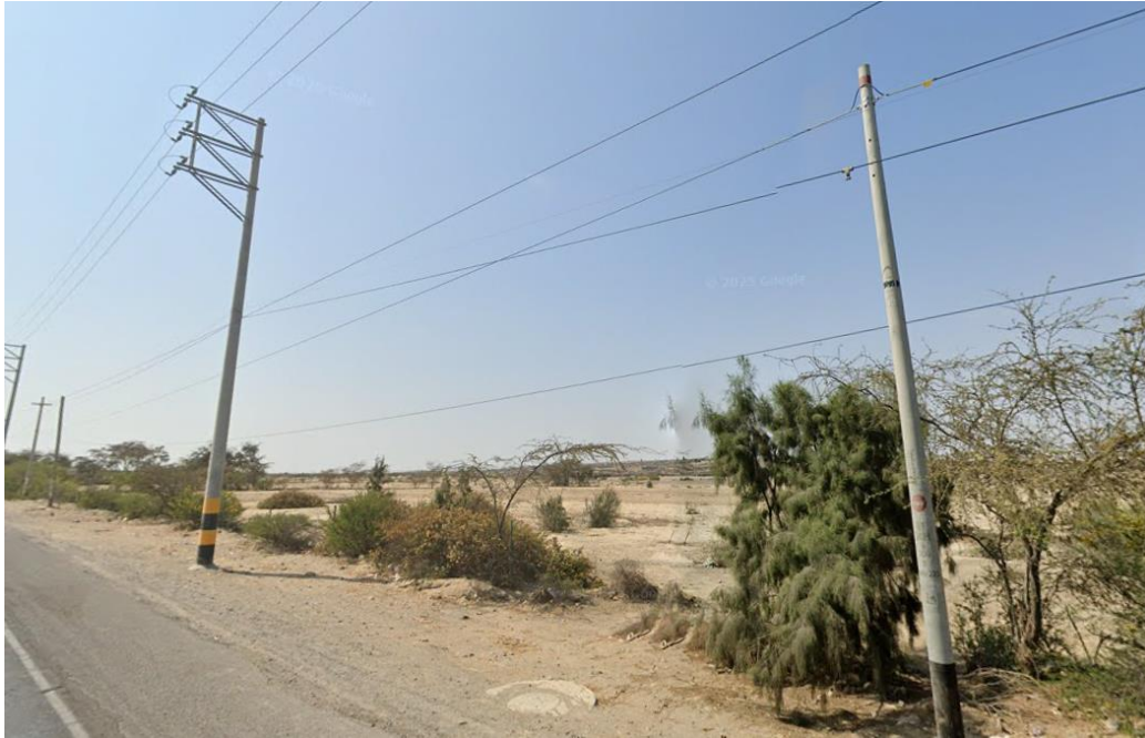
Imagen N° 29. Imagen del Sistema Eléctrico.
