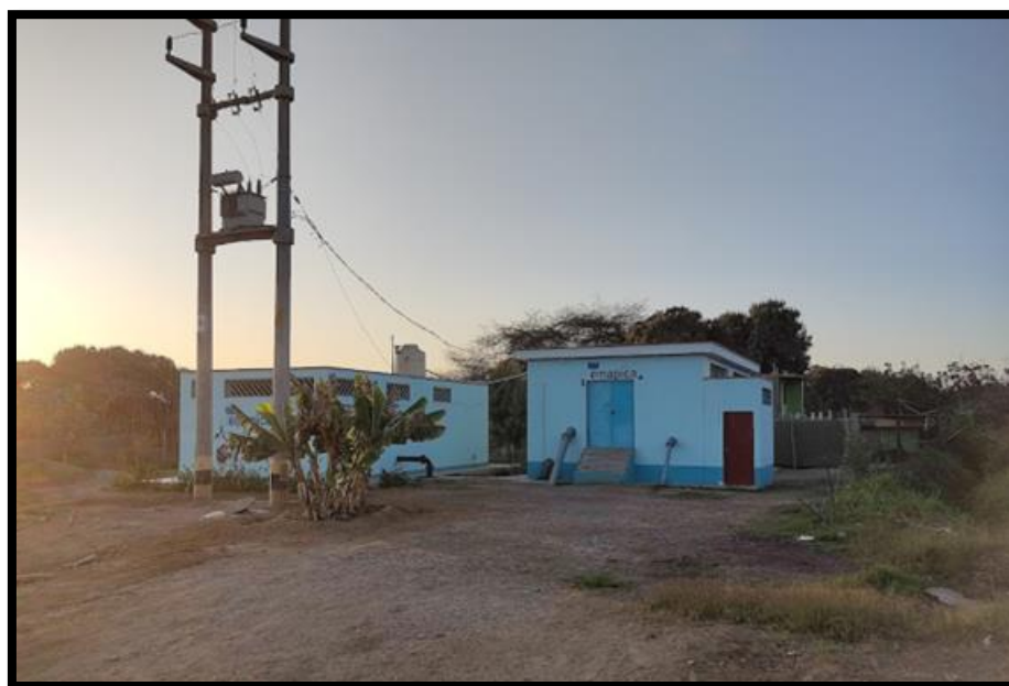
Imagen. - Pozo de agua potable que abastece al sector
