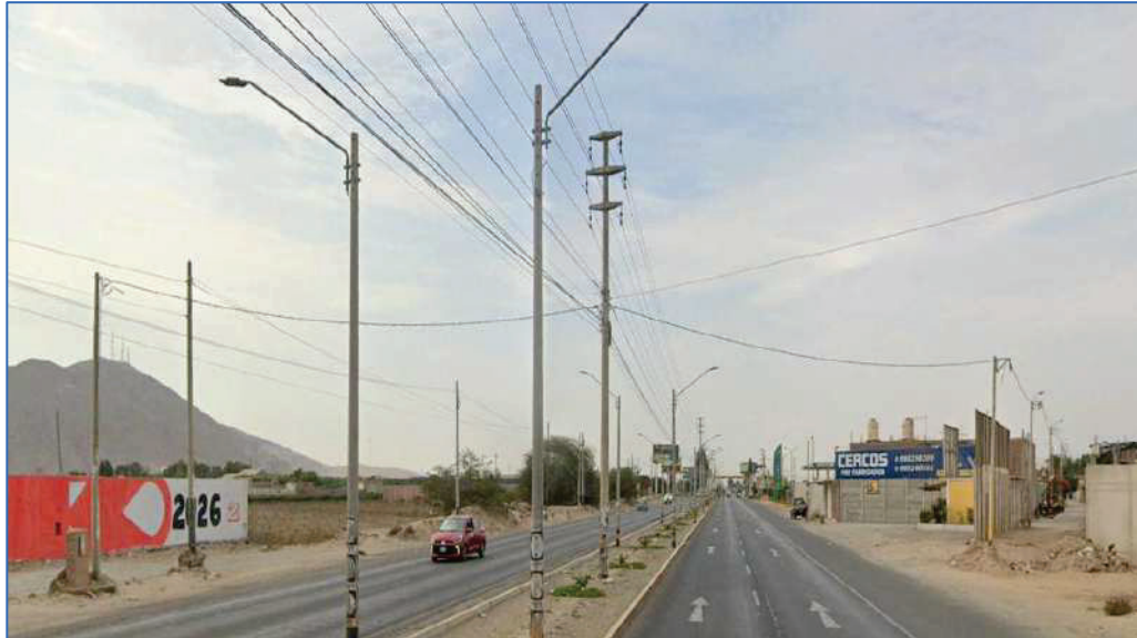
Imagen N° 30. Imagen del Sistema Eléctrico.
